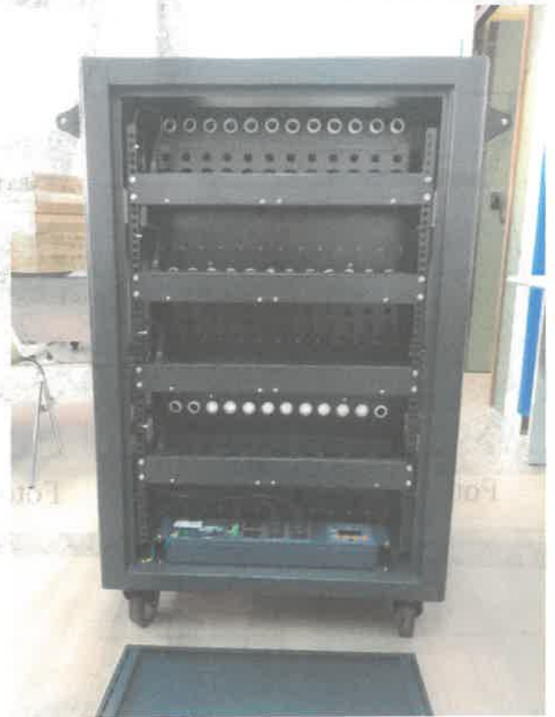
Foto 14 Carrello (lato posteriore) con attacchi elettrici
